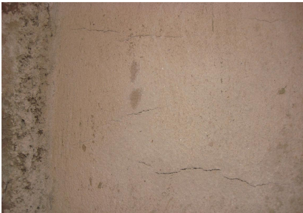
Figura 4.10 – Fissuras no painel com retardador de pega MSET-R.
