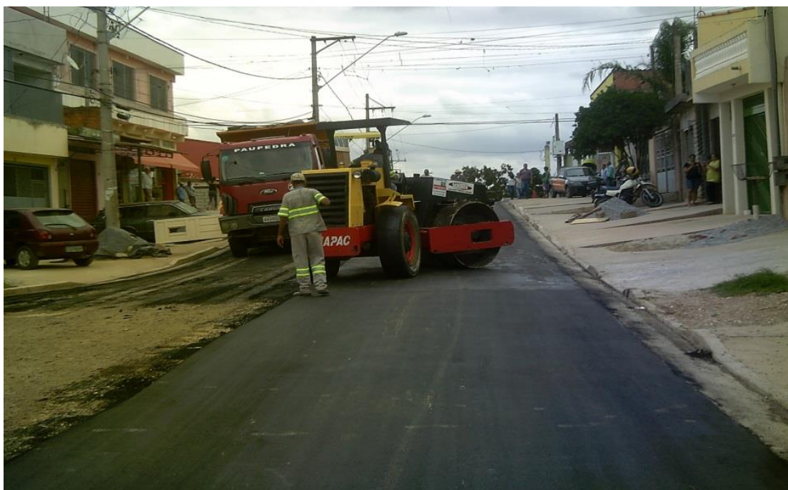
FIGURA 15: Execução da camada de revestimento de Concreto Betuminoso Usinado à Quente, na rua Lagedão. (CORDEIRO, 2014).
