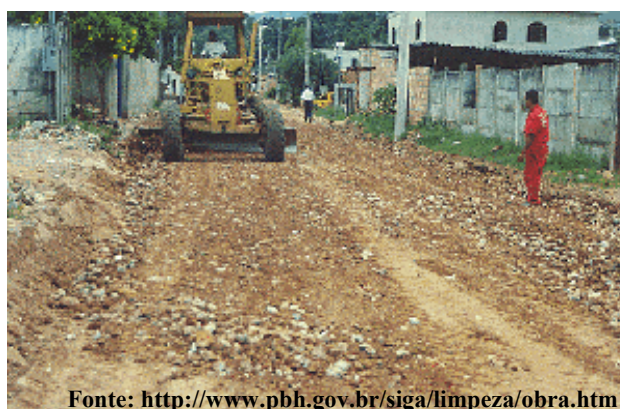
Figura 4.3: Execução da sub-base de pavimento com agregado reciclado na Rua Adelina Amaral Pongelupe em Belo Horizonte (MG)
