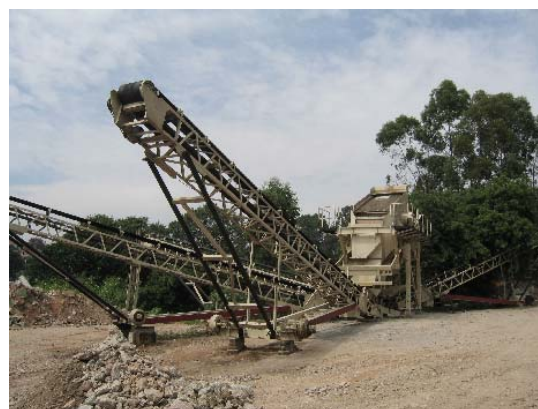
Figura 3.15: Vista do peneirador mecânico da usina de reciclagem da PMSP, com aberturas de peneiras de 4,8mm, 20mm e 40mm
