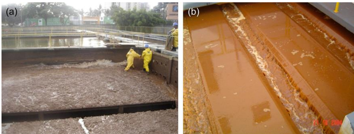
Figura 1.4 - (a) Imagem de decantador em manutenção; (b) Imagem de filtro em operação (SANEPAR, 2010)
