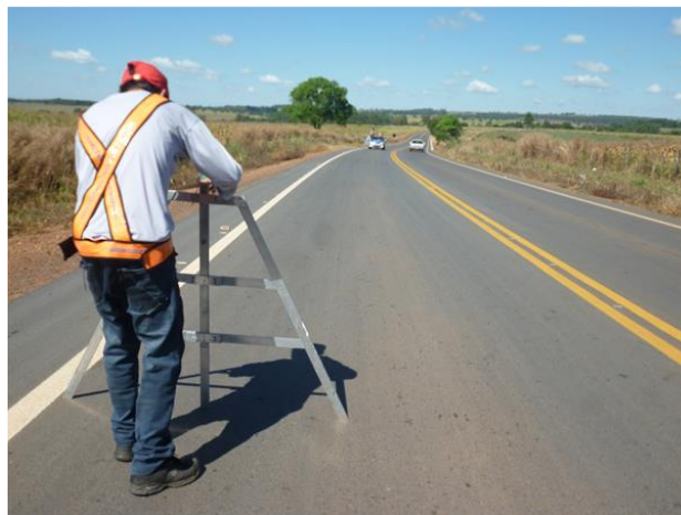
Figura 3.8 - Levantamento do afundamento de trilha de roda
