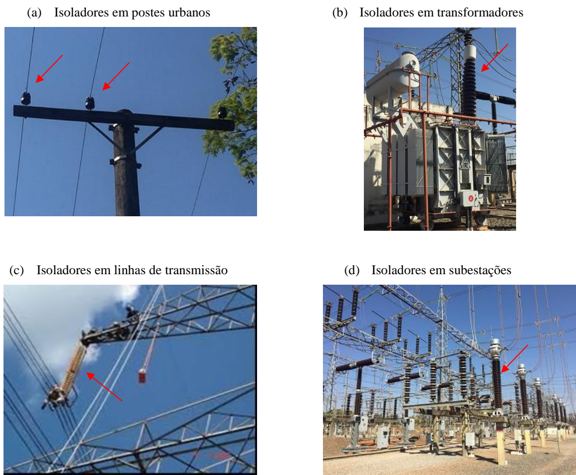
Figura 1.1 - Exemplos de utilização de isoladores no sistema elétrico
